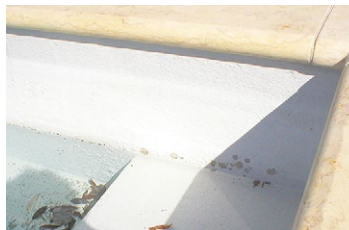
Piscina privata - Città di Castello (PG) (particolari prima dell'intervento)
