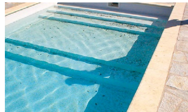
Piscina privata - Città di Castello (PG) (particolari prima dell'intervento)
